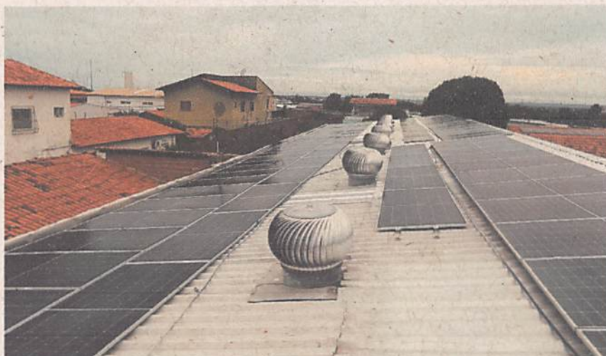
TELHADO DA EMPRESA POLO SUSTENTÁVEL COM OS PAINÉIS DE ENERGIA SOLAR, EXAUSTORES EÓLICOS E COM PINTURA BRANCA PARA REFLETIR OS RAIOS SOLARES DAS TELHAS.
