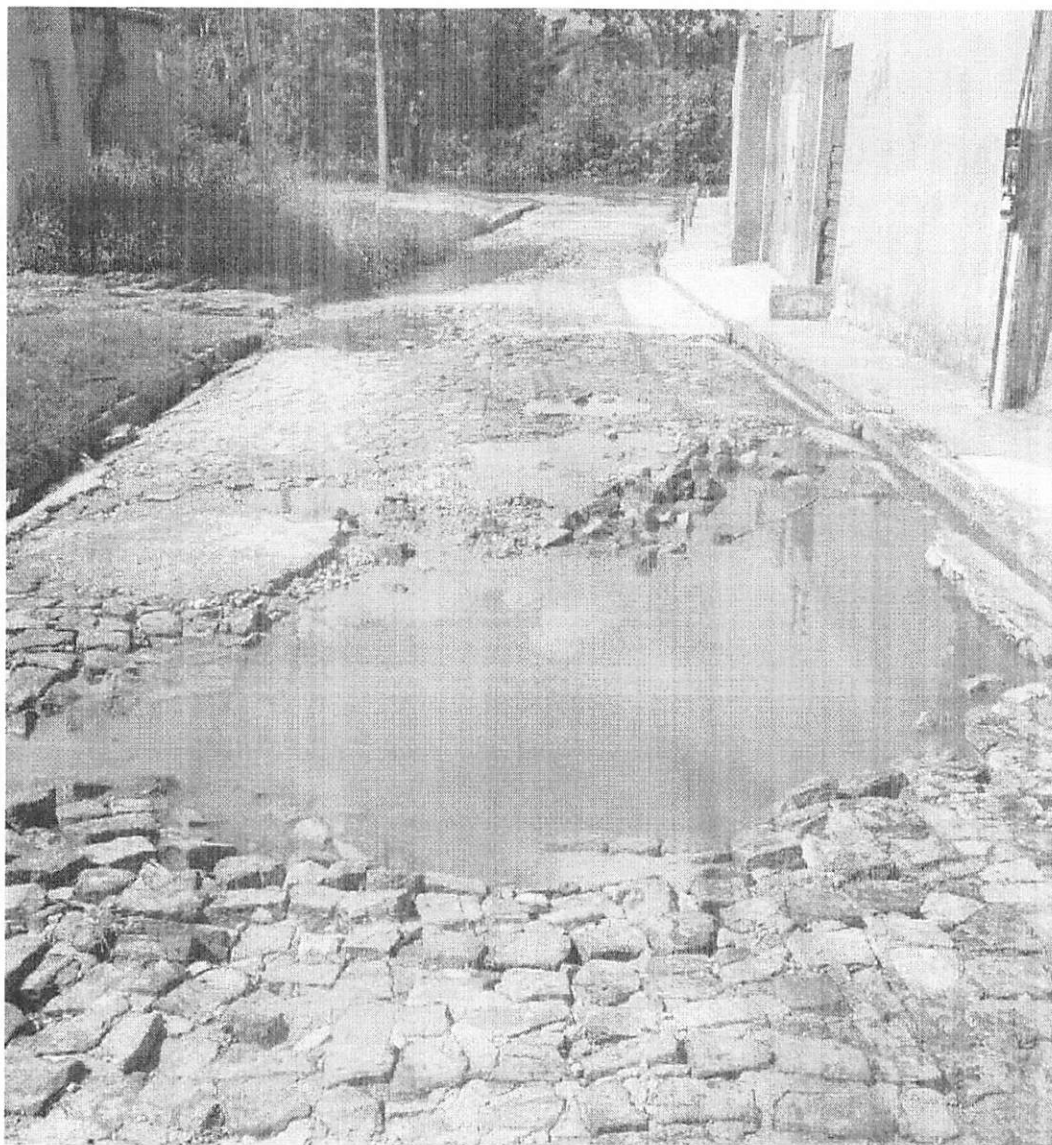
Figura 2: Os buracos causados pela enxurrada da chuva permanecem com água empossada, trazendo transtornos à população como mau cheiro e sérios riscos à saúde.
