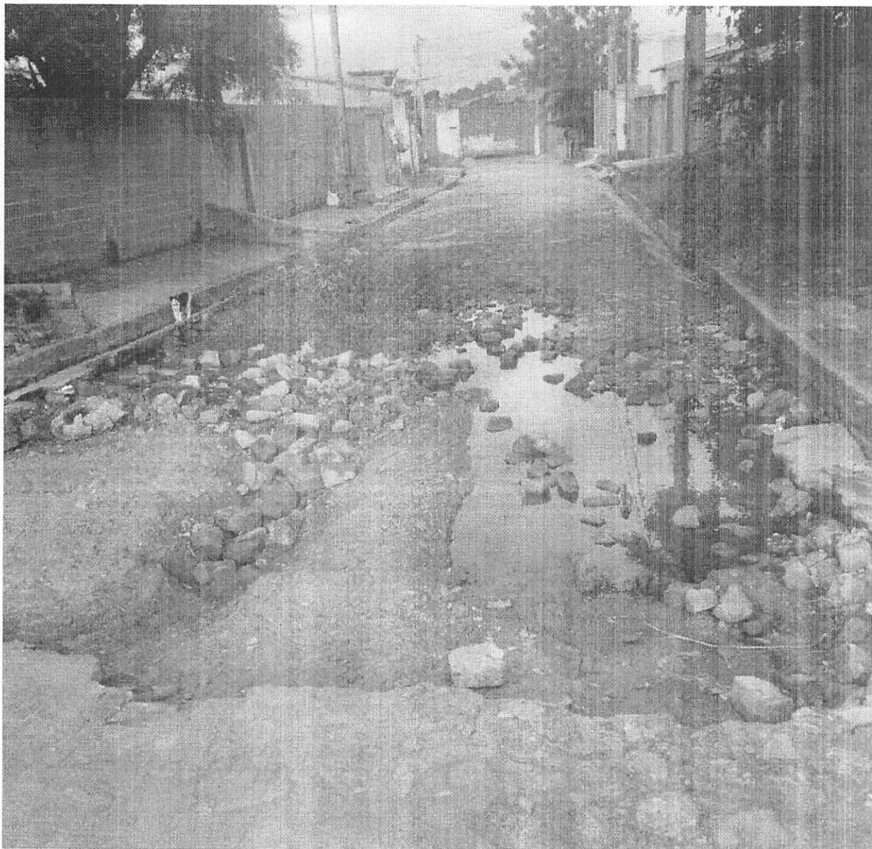
Figura 2: As fortes águas da chuva estão causando severos danos a pavimentação das ruas Boa Esperança, impedindo a locomoção e acesso às mesmas.
