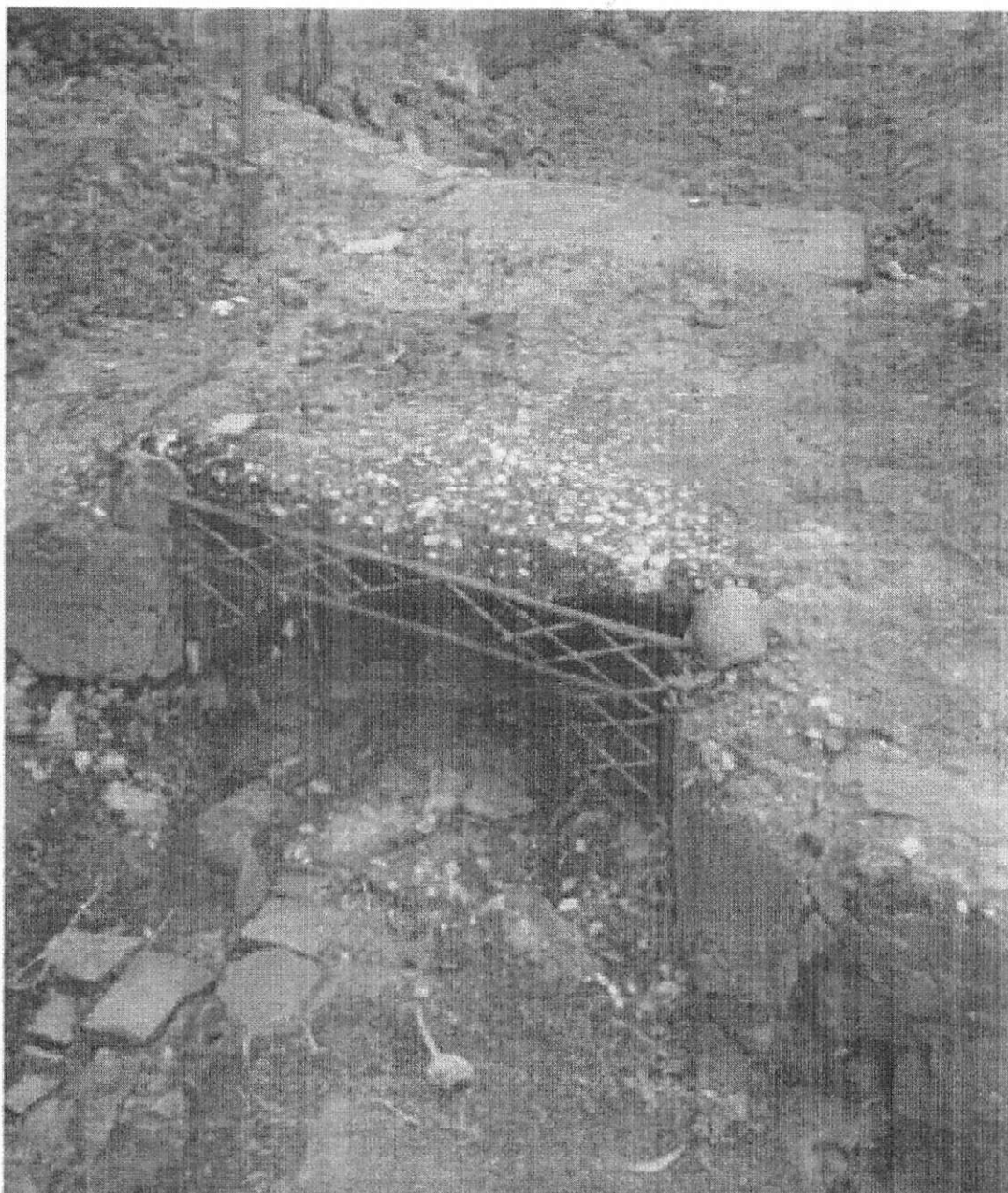
Figura 1: Galeria localizada no bairro Santo Antônio, com infraestrutura deteriorada e sem estruturação devida, o que prejudica as instalações residenciais da localidade.
