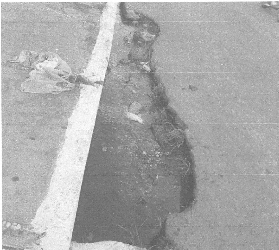
Figura 2: A sarjeta situada entre estabelecimentos alimentícios situados em uma avenida bastante movimentada, encontra-se danificada, onde há acúmulo de água parada misturada a esgoto e águas pluviais, ocasionando odor desagradável e potenciais riscos sanitários.
