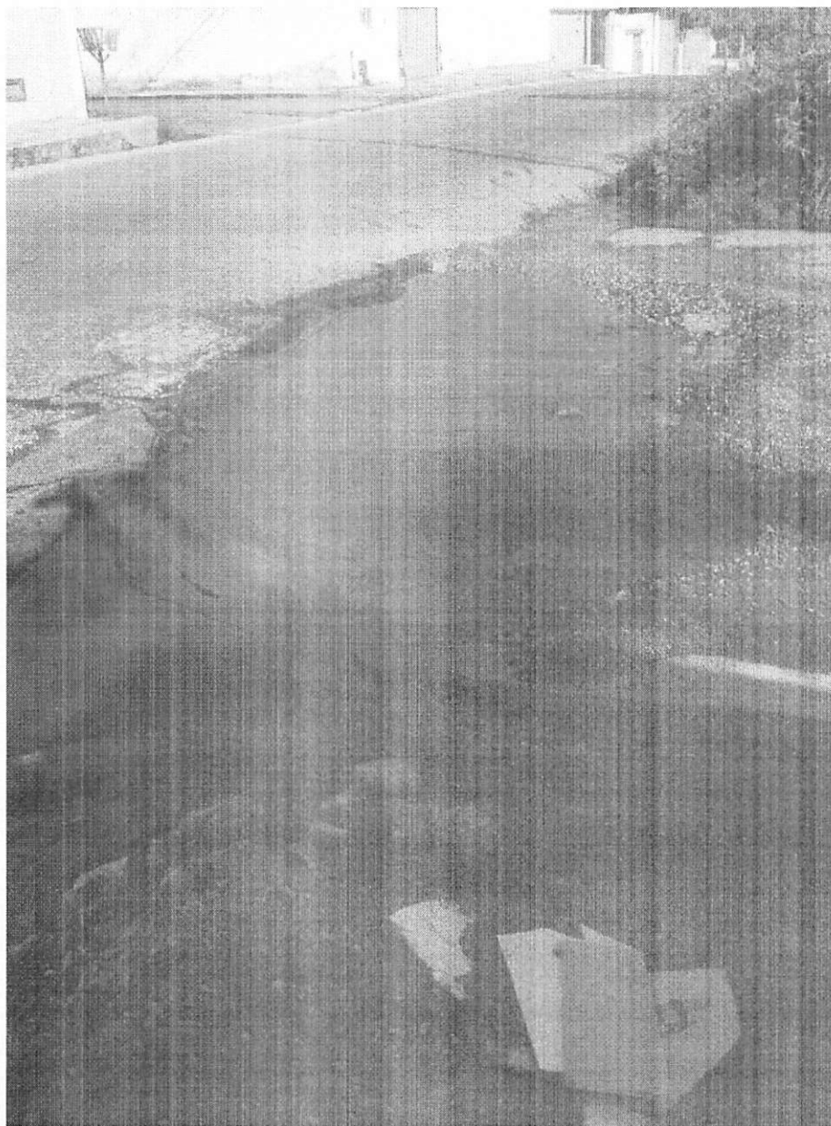
Figura 2: A via se encontra danificada causando diversos transtornos aos moradores e aos transeuntes da região, além do odor e riscos a saúde e bem-estar ocasionados pelo acúmulo de água.
