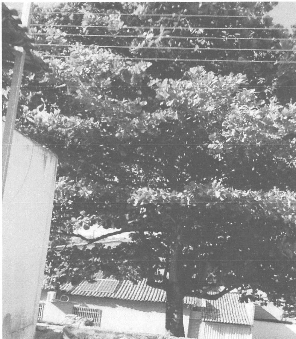
Figura 2: A árvore retratada apresenta crescimento excessivo, com galhos alcançando a rede elétrica.
