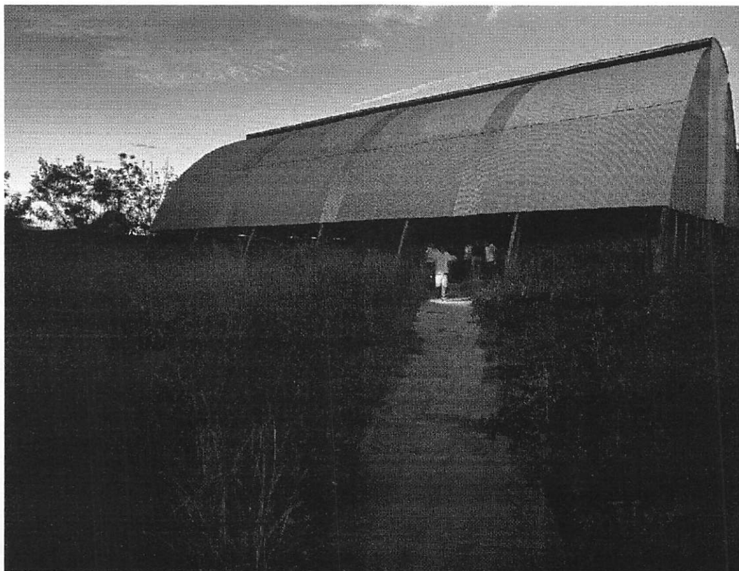
Figura 3: Sem iluminação e cercada pelo mato alto, a quadra escolar se tornou um local inseguro. A atual situação compromete as atividades físicas e recreativas dos alunos, além de expor todos ao risco de acidentes e presença de animais peçonhentos.
