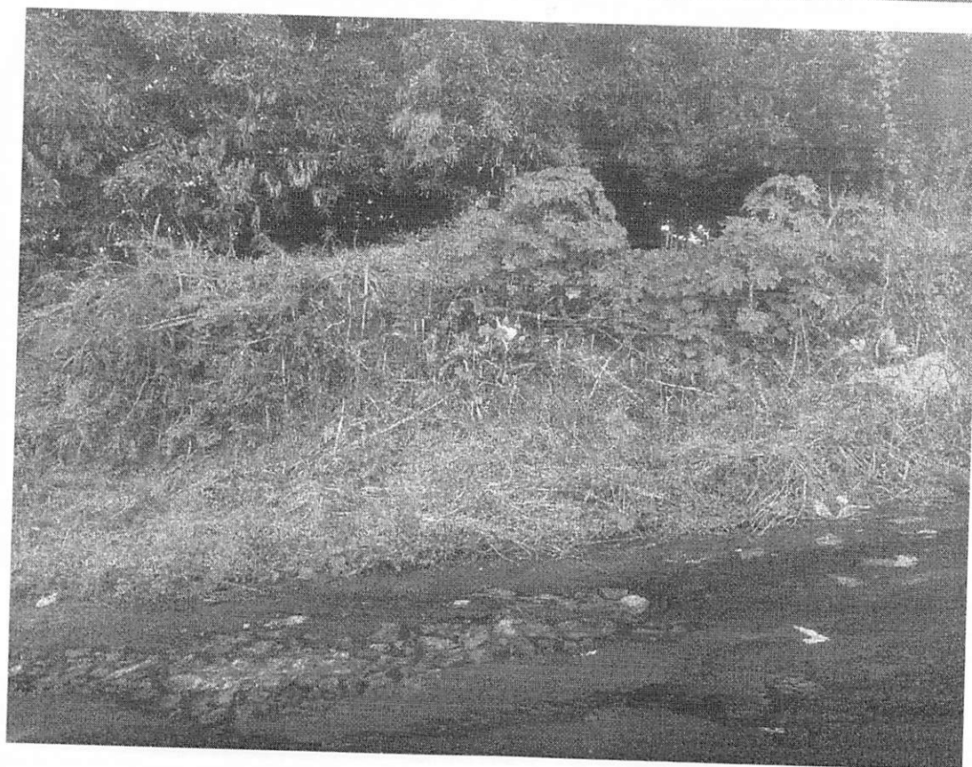
Figura 2: A via está com sua estrutura degradada, causando diversos transtornos a comunidade local, dificultando a mobilidade.
