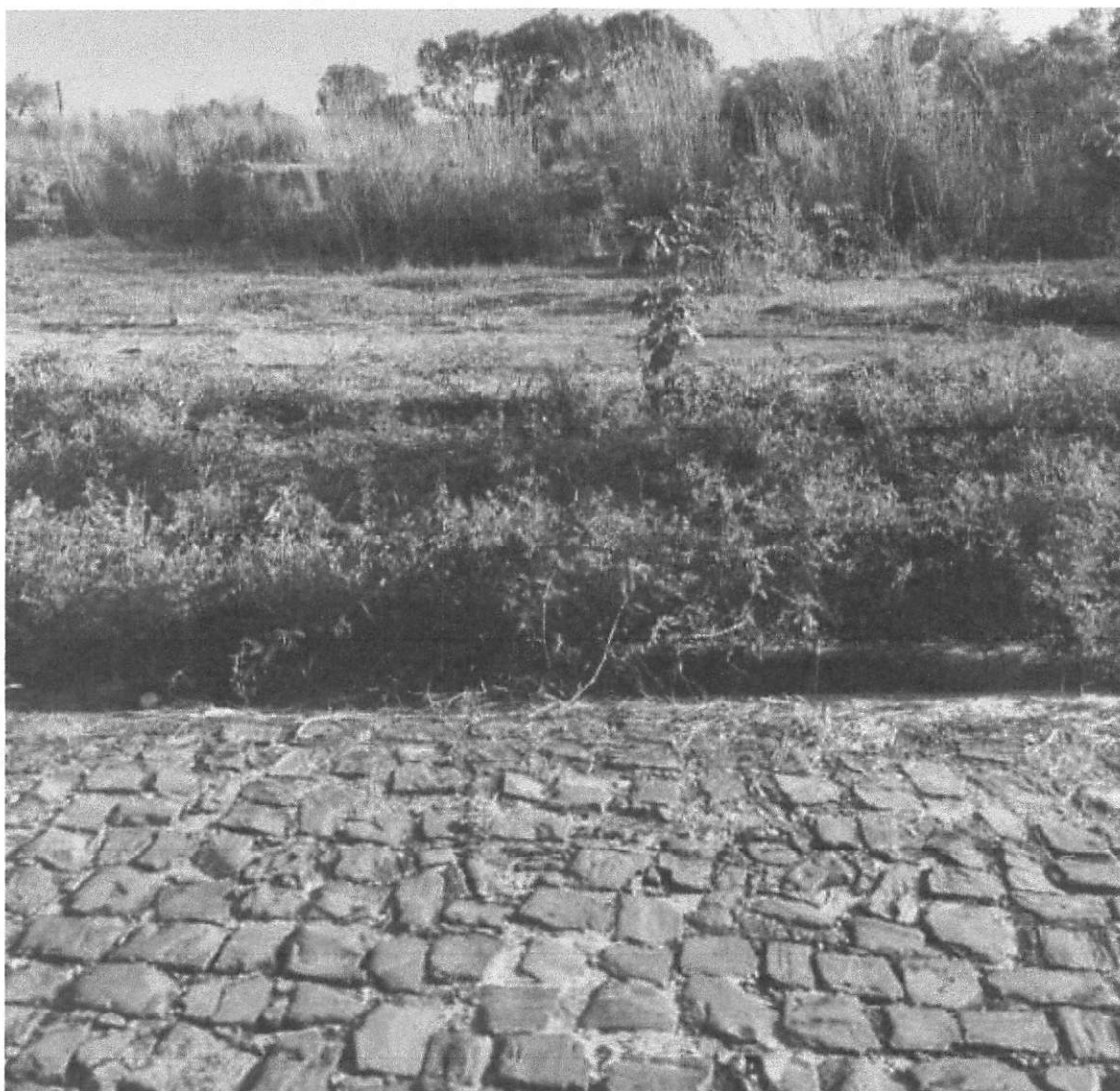
Figura 4: Registro das condições atuais do local, justificando a realização dos serviços de capina e limpeza para melhoria da circulação e conservação da área.
