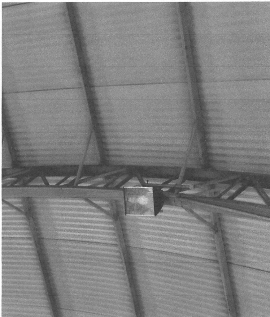
Figura 04: Registro fotográfico dos refletores instalados na quadra poliesportiva, objeto da presente solicitação de intervenção.
