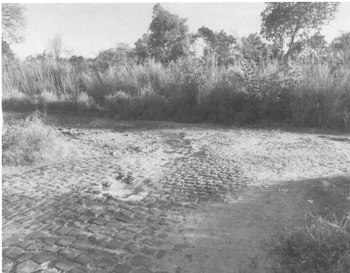
Figura 3: Registro fotográfico de trecho da via pública com irregularidades que comprometem a mobilidade e a segurança dos usuários
