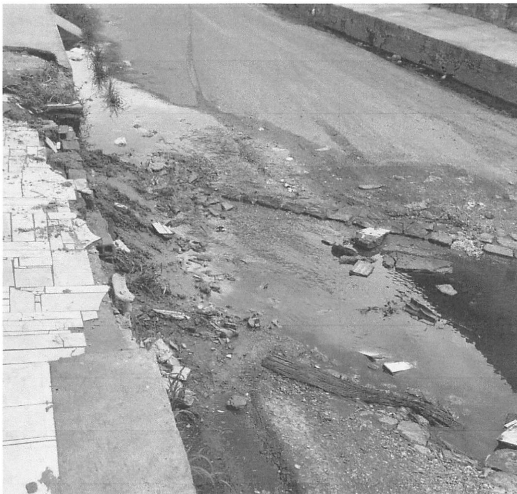
Figura 2: Registro atual da via, evidenciando falhas no sistema de drenagem, comprometendo o adequado escoamento das águas e ocasionando diversos transtornos aos moradores e transeuntes da região.
