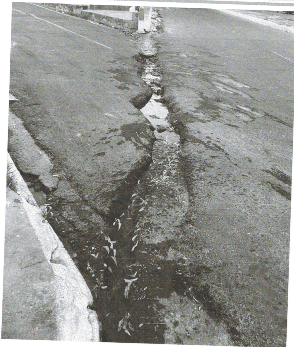
Figura 03: Canaleta apresentando deterioração estrutural, desnível acentuado e irregularidades que comprometem a trafegabilidade da via e têm causado danos aos automóveis que transitam pelo local.
